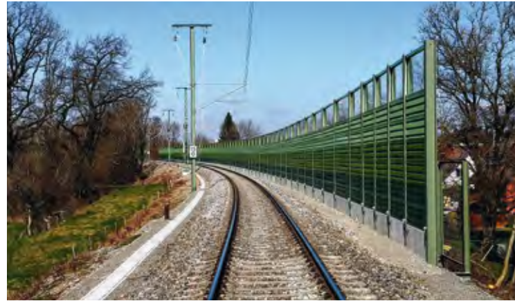
Schallschutzwand Wangen-Gehrenberg mit vier Meter Höhe
